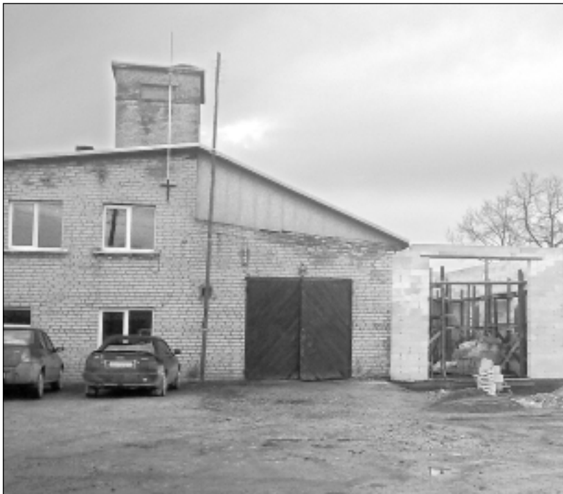
Būvē savējie. Garāža nav liels objekts, tādēļ to būvē savējie - celtnieki no Balviem, ar kuriem līgumu slēgusi ugunsdzēsības dienesta vadība.
