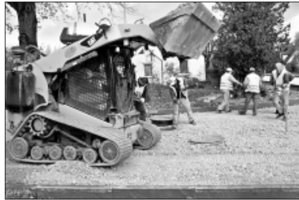
Pēdējie šķembu izlīdzināšanas darbi Raiņa un Bērzpils ielu krustojumā. Harijs Šūtelis to dara ar savu traktoru, bet vīri vienkārši - ar lāpstām. Tūlīt nāks asfalta ieklājējs, un līdz tam visam jābūt gludam un līdzenam.
