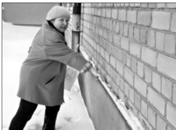
Pirkstu var iebāzt! Tatjana Mitjušina demonstrē, ka pamatos jau izveidojušās plaisas.
