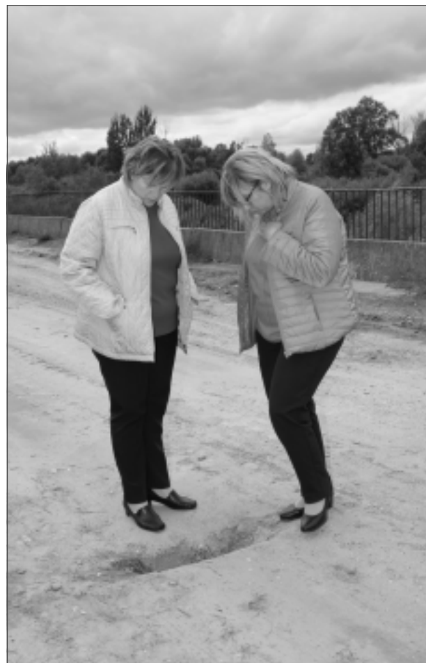
Apskata Ičas tiltu. Iepazīstoties ar Bērzpils pagastu, jaunizveidotā novada vadība apmeklēja arī Ičas tiltu, kur novērtēja tā stāvokli (attēlā domes priekšsēdētāja vietniece Sandra Kapteine un izpilddirektore Daina Tutiņa).
