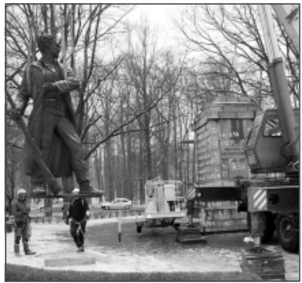
16.decembris. Balvos nocēla tautā saukto Staņislava skulptūru, līdz ar to sākās Latgales partizānu pulka kritušo karavīru pieminekļa remonts, kas turpināsies arī 2021.gadā.
