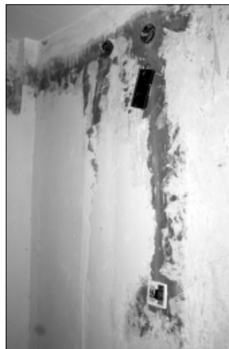
Dzīvokļa iekšpusē. Elvīras dzīvoklim koridorā nav tapešu, elektrības vadi atvienoti, slēdži nedarbojas. Viņas dzīvoklis no slapjuma ir cietis visvairāk.
