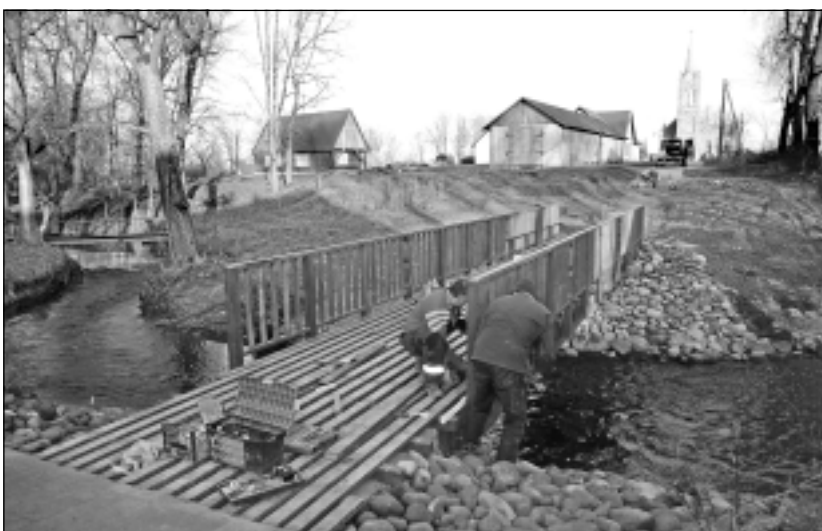
Jauna gājēju laipa. Pāri Supenkas upei Baltinavā tapusi jauna gājēju laipa, kas ērti un droši ļaus mērot ceļu uz katoļu dievnamu un daudziem būs isākais ceļš. Iespējams, ka ticējums iedomāties vēlēšanos, pirmo reizi ejot pāri jaunam tiltam, attiecas arī uz gājēju laipu, kas arī ir mazs tiltiņš.
