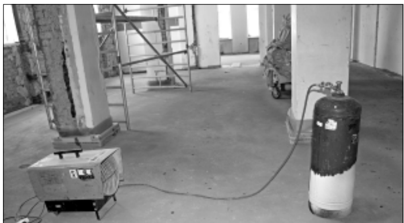
Aukstums nav šķērslis. Rekonstrukcija objektā notiek arī ziemas mēnešos. Lai iekštelpās nodrošinātu minimālo temperatūru un veiktos darbs, izmanto sildītājus. Tas gan būvniekiem rada papildu izdevumus. Darbu pasūtītājs cer, ka drīzumā apstiprinās otrās kārtas plānotos darbus, un līdz ar to visas rekonstrukcijas gaita kļūs straujāka.
