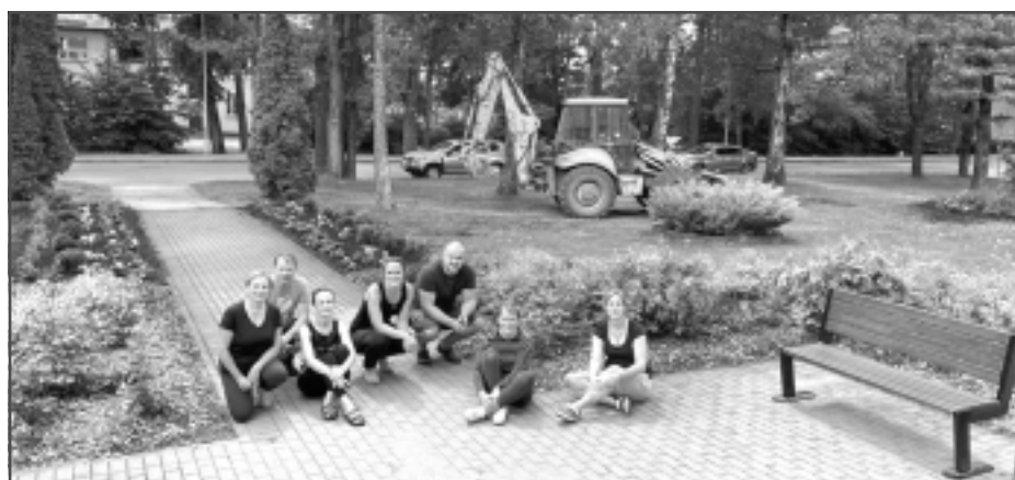
Bez palīgiem neiztikt. Balvu slimnīcas apkārtnes labiekārtošanā palīgā nāca visi, - darbu veiksmīgai izpildei nepieciešams bija pat traktors.
