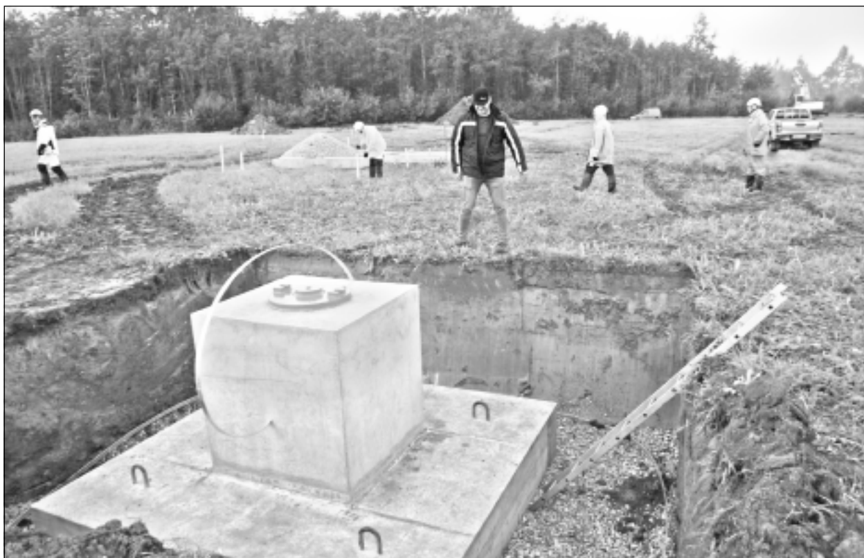
Izbūvē laukumu. Šonedēļ Aizpurvē, pļaviņā netālu no ceļa, notika rosīgi būvdarbi. Būvnieki ierīkoja vietu un izbūvēja pamatus jaunajam Latvijas televīzijas un radio apraides tornim pierobežā.
